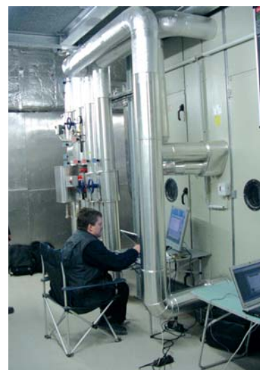
Blick auf Teilklimaanlage, Technikzentral 2 / Nord bei der Inbetriebnahme der MSR-Technik
