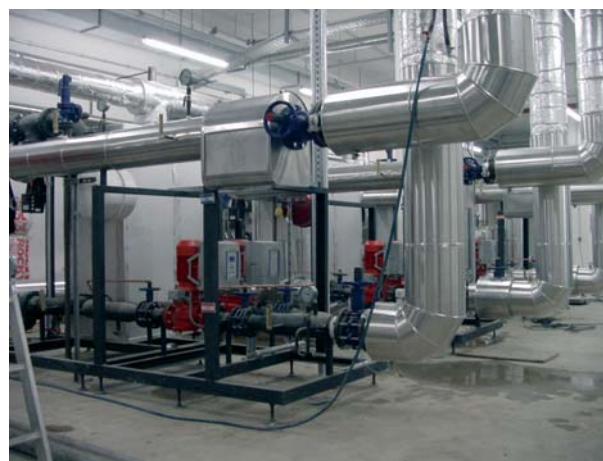
Drei Wärmetauschergruppen Messe West. Heizzentrale UG als Rücklaufversorgung
