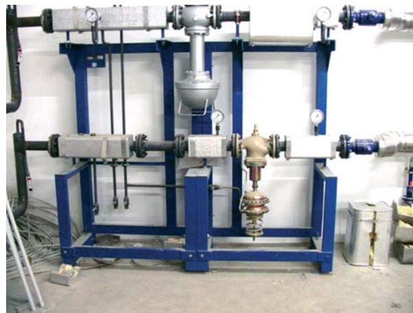
Druckreduzierstation Fernwärme (HEW); Vorlauf, Foyer, Heizzentrale UG
