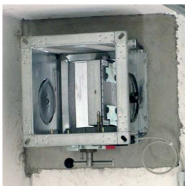
Beispiel der brandschutztechnischen Abschottung vor den Traforäumen
