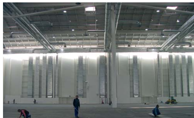
Blick an die Hallenrückwand mit den symmetrisch aufgeteilten Abluftsammelkanälen
