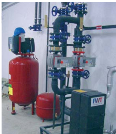
Foyer UG / Heizzentrale - Wärmetauschergruppe Verwaltungsgebäude
